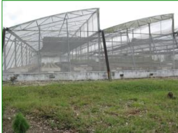
Figura 1. Cámaras de Aclimatización. Instituto de Biotecnología de las Plantas. Villa Clara.
